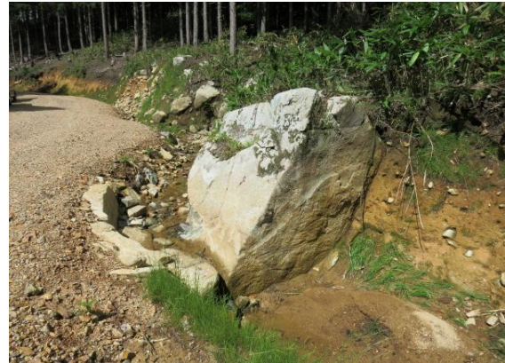
4) 降雨後でも石の浸食防止で被害なし
