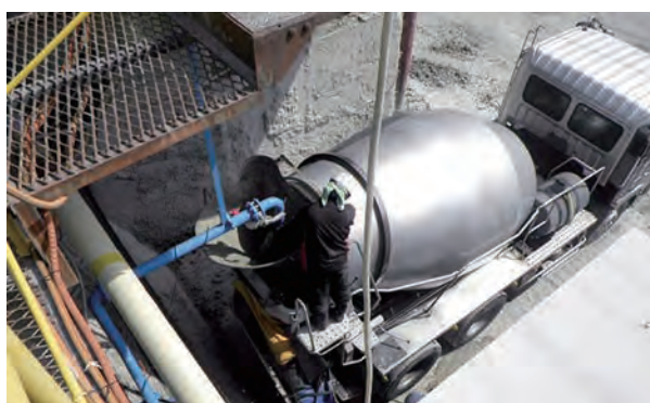
福島県相馬に仮設したLSS相馬出荷設備で、ここより泥水を現場に搬出する。
