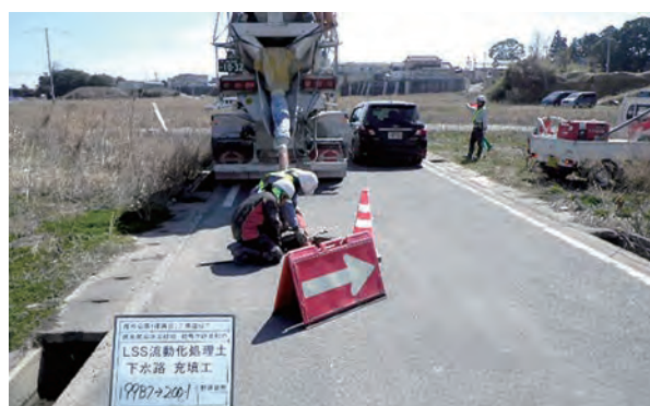
少量の場合は現場において固化材スラリーを製造し、泥水と混合して流動化処理土を製造打設する。
