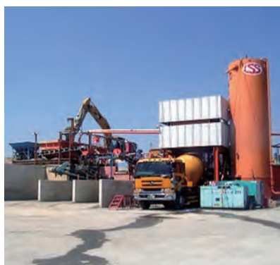
本拠地「LSS 浜松プラント」建設汚泥の中間処理施設を兼ねる
